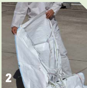
Vouw de containerzak open. Signaleer een eventueel defect onmiddellijk aan Mirom Menen
